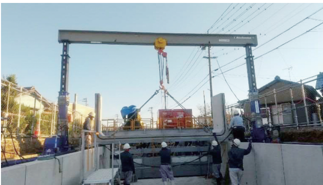
U型水路据付工事 トラックの荷台から直接取卸し据付を行っています
